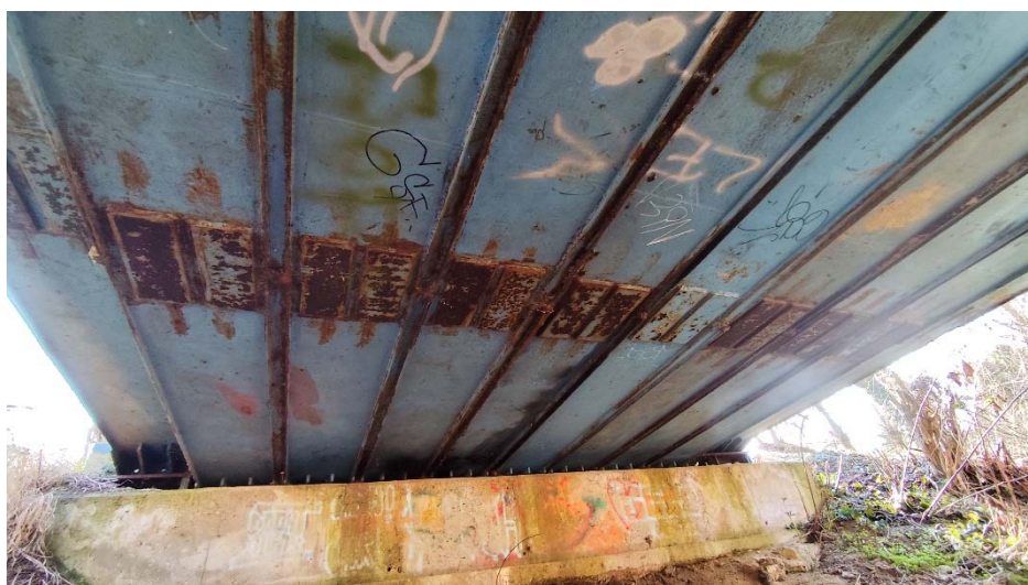
8. kép Korrodált acélszerkezetű felépítmény
