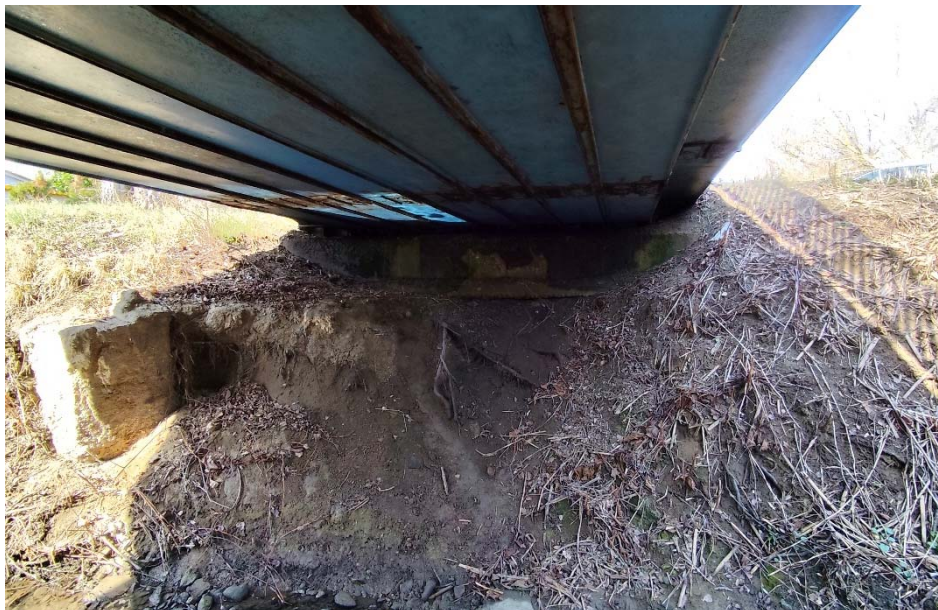
7. kép Korábbi felmenő szerkezet, alámosódás hídfőnél
