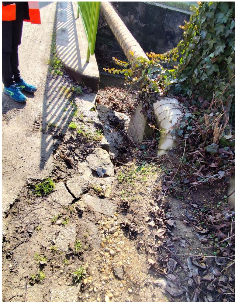
12. kép Vízelvezetés hiánya miatti útkárosodás
