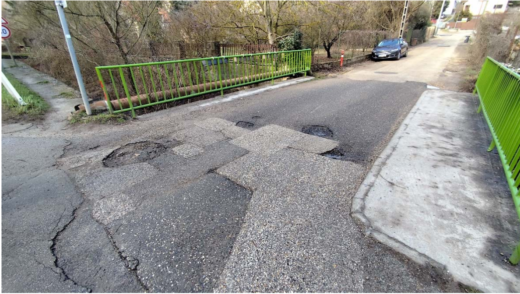
11. kép Csatlakozó út és hídburkolat hibái
