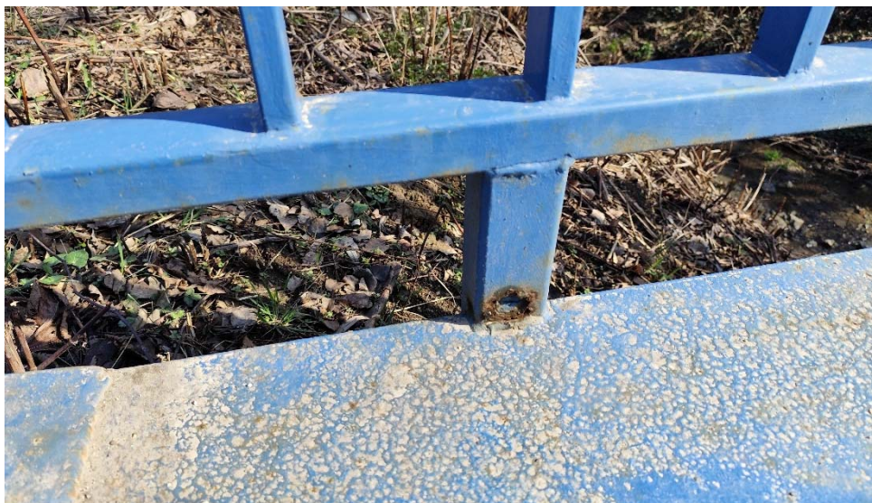
12. kép Lokális korrózió acélkorlát csatlakozásánál
