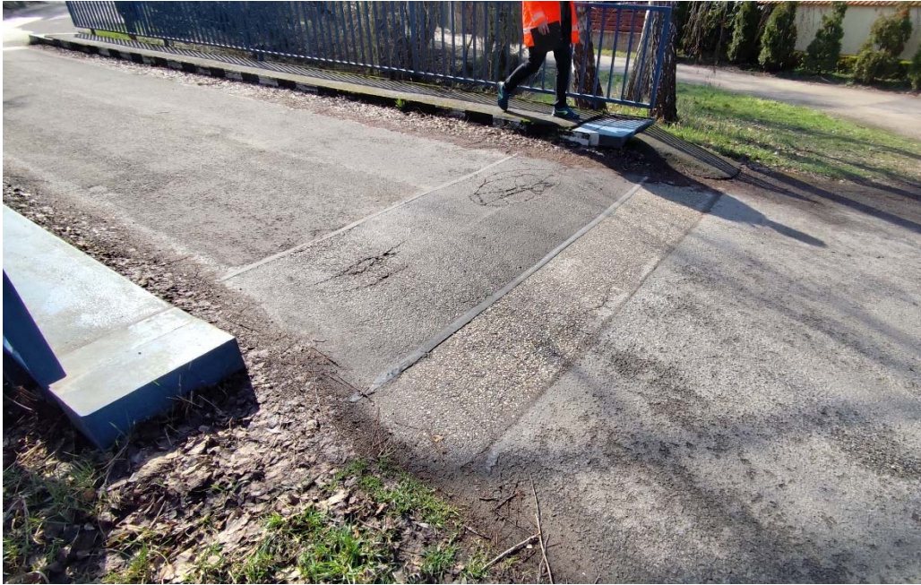
13. kép Csatlakozó út burkolati károsodása
