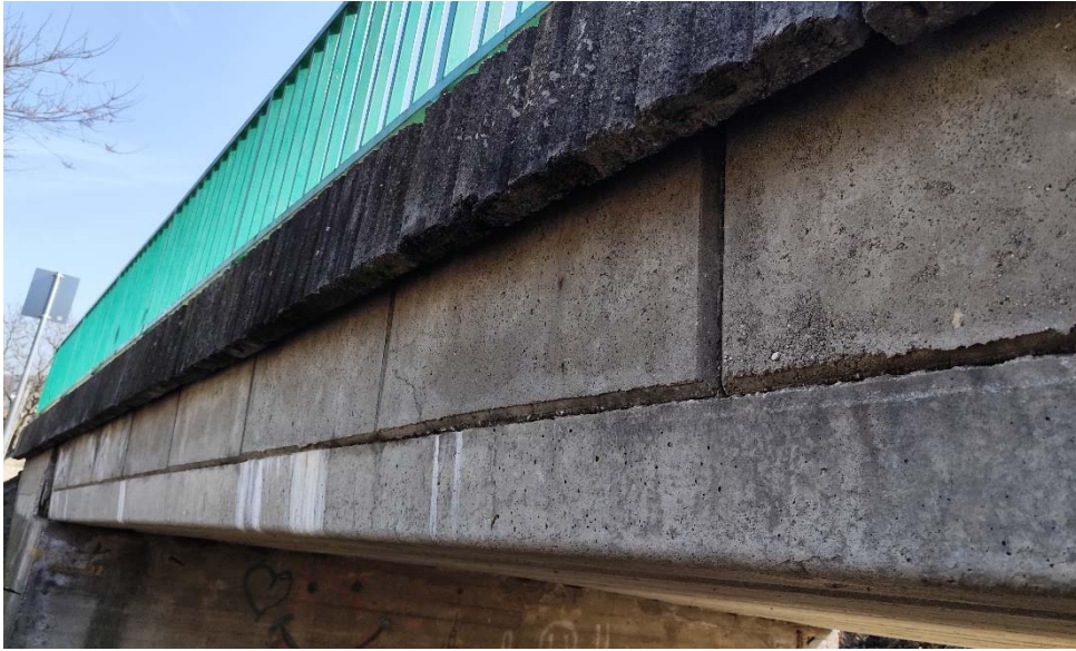
11. kép Acélkorlát és korrodált betonszegély
