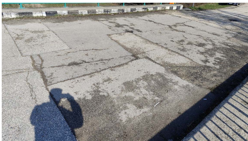
10. kép Útburkolati repedések, kátyúk
