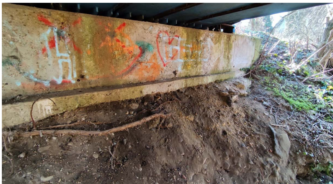
6. kép Hídfő állapota, rézsűburkolat hiánya
