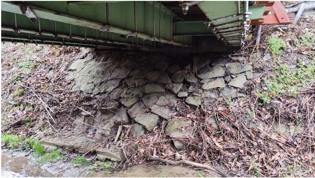
5. kép Leromlott állapotú előtöltés Fő út felőli oldalon
