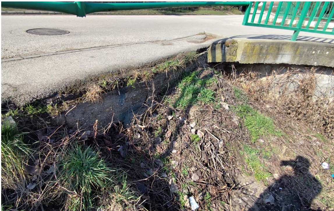
12. kép Csatlakozó út károsodása
