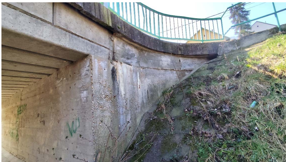
9. kép Vasbeton szárnyfal ázásnyomok, felületi korrózió
