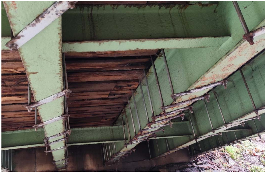
7. kép Acélgerendákon látható felületi korrózió
