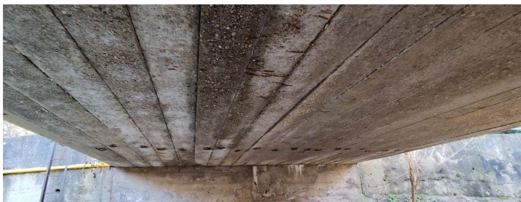
6. kép Felületi korrózió a felszerkezet vasbeton főtartóin
