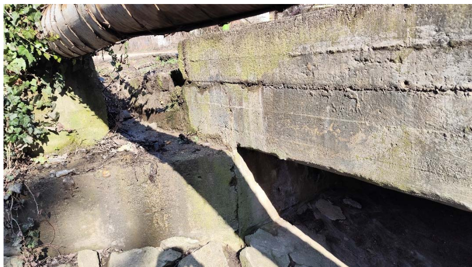
8. kép Vízfolyás nyomai a szárnyfalaknál
