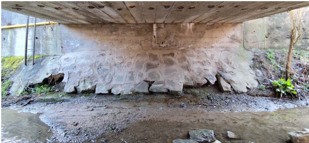
4. kép Híd rézsűburkolat kimosódása
