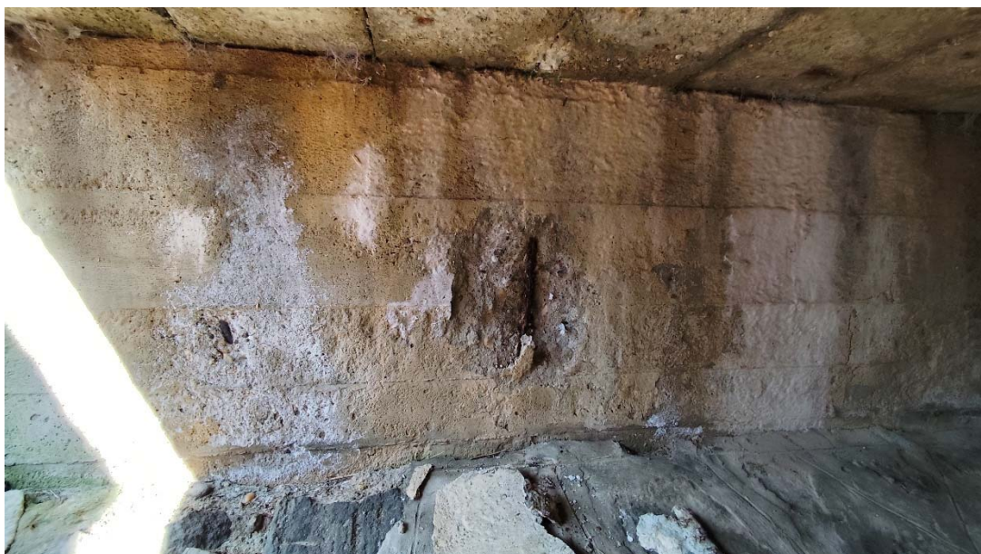
5. kép Sókivirágzás, felületi korrózió a hídfő betonszerkezetén
