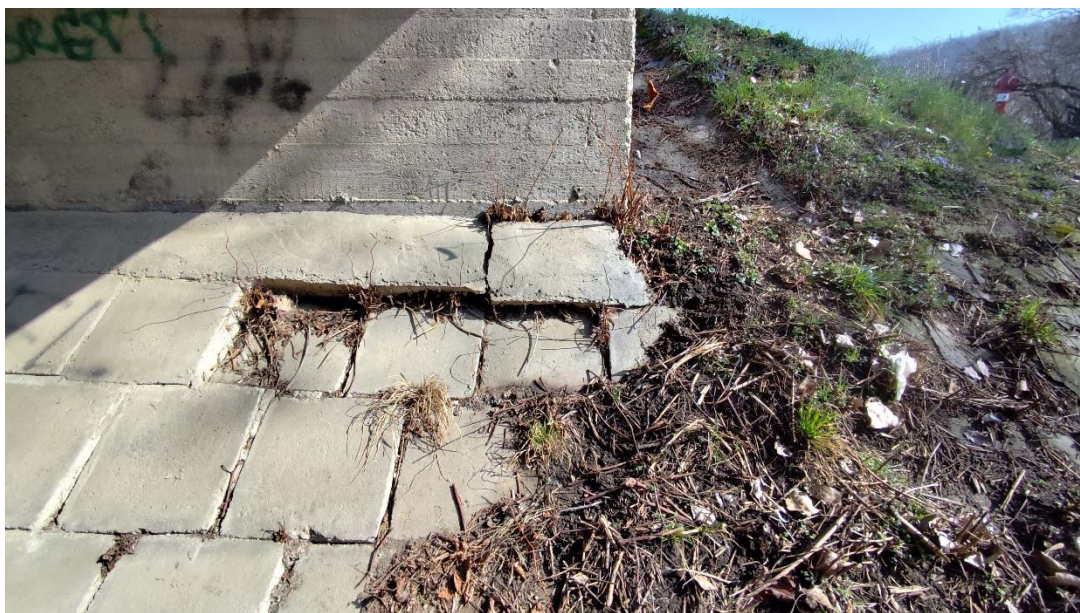
5. kép Előtöltés burkolat beszakadás
