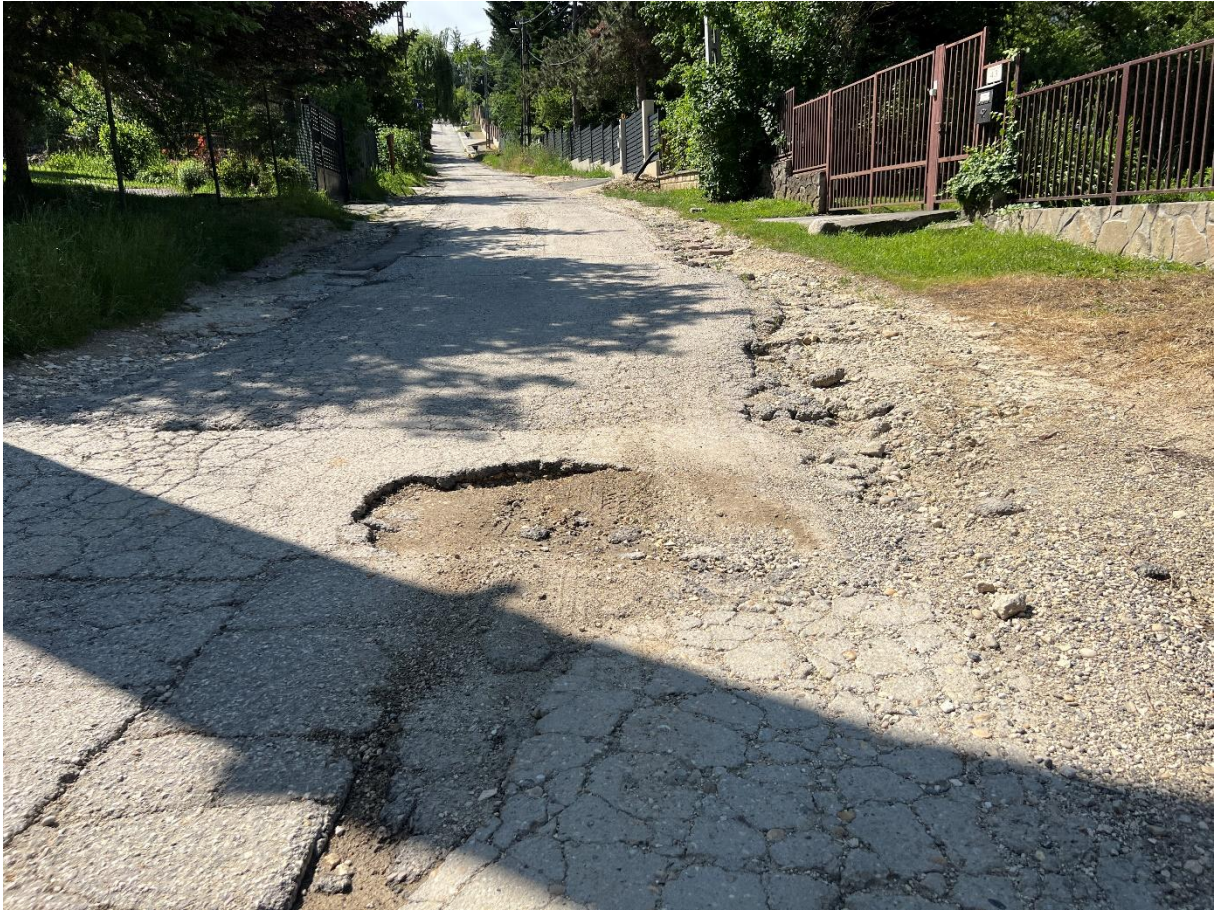
3. kép – mozaikosan összetört aszfaltburkolat, alépítményi hibák, kátyúk
