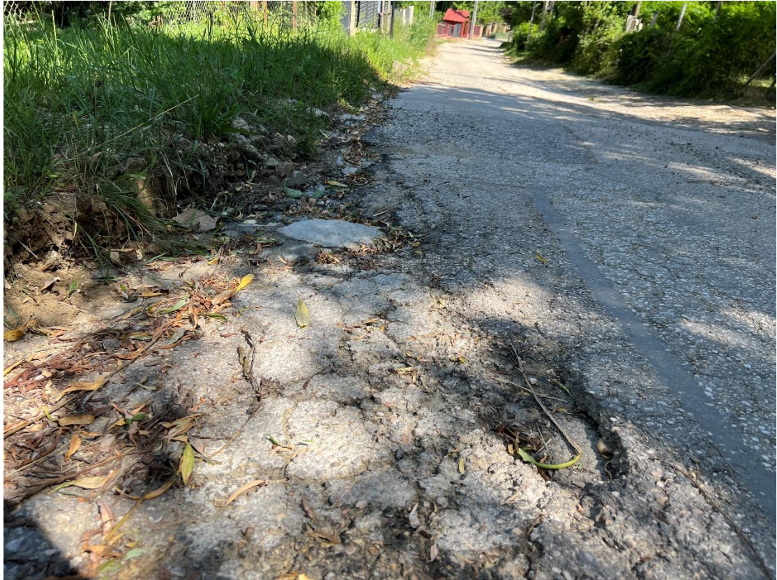
3. kép – Üdülők útja, tönkrement útburkolat
