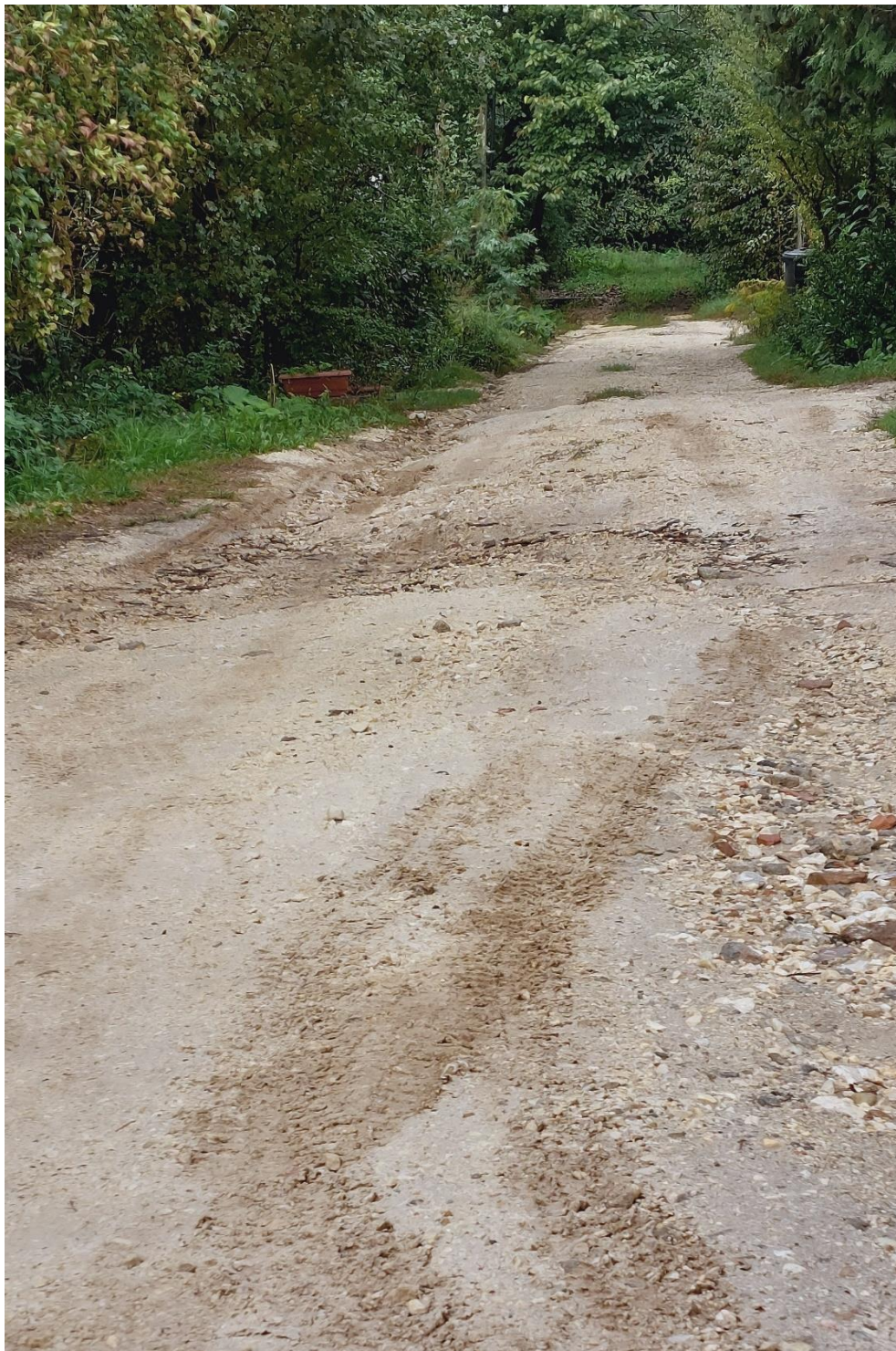
5. kép – Oszoly utca (791/41 hrsz) kimosódás
