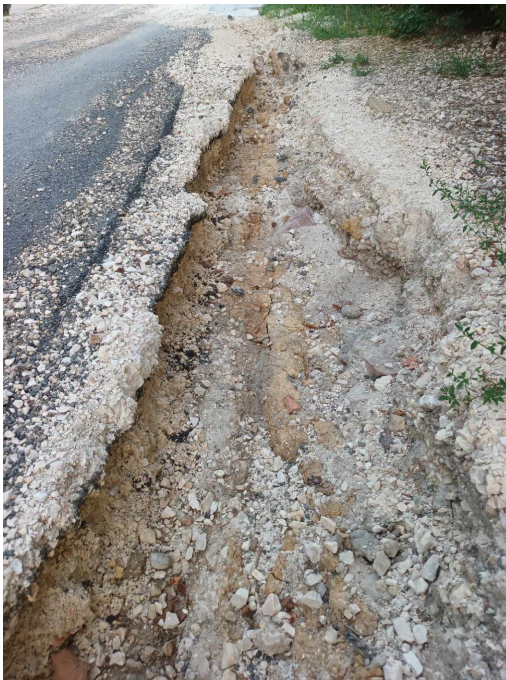
1. kép – Kevély utca (791/28 hrsz.) mély kimosódás az útszélen
