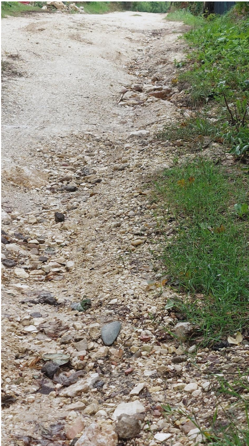
6. kép – Oszoly utca (791/41 hrsz) kimosódás
