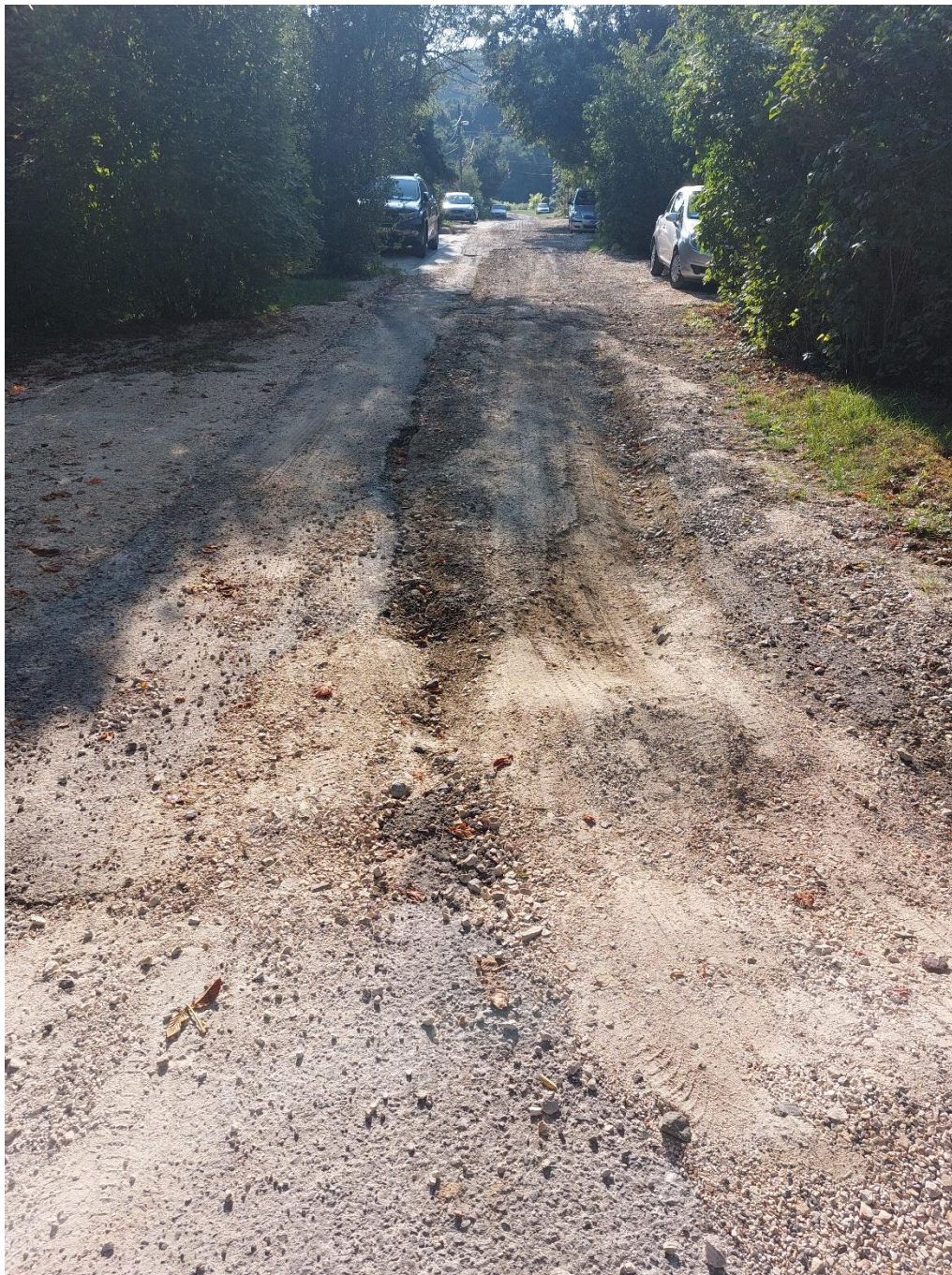
3. kép – Kevély utca (791/28 hrsz.) kimosódás az útburkolaton
