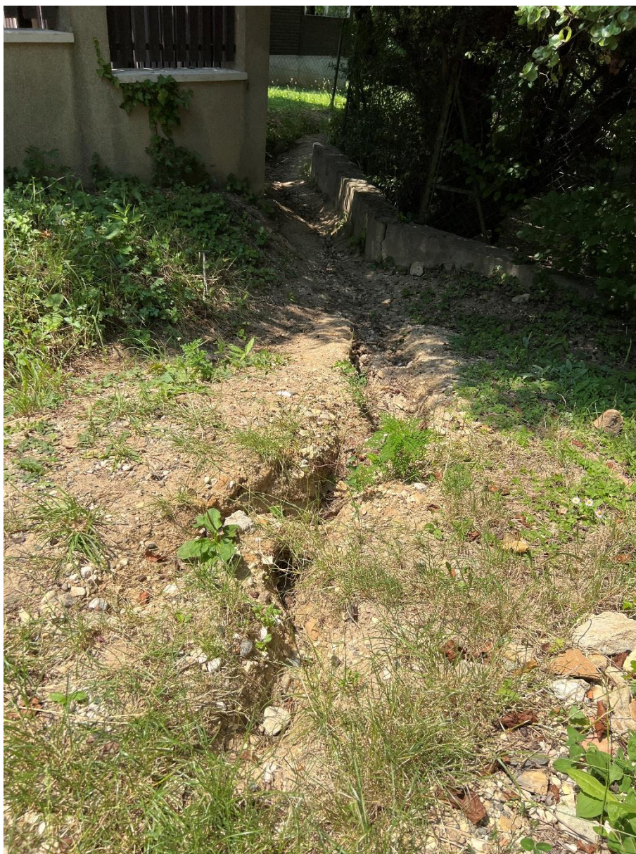
9. kép – Kevély köz 790/5 hrsz. árokkár
