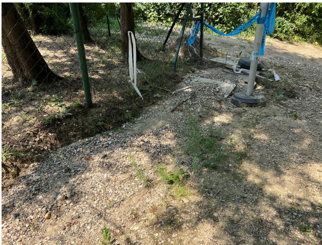
11. kép – Kevély köz 790/5 hrsz. árokkár
