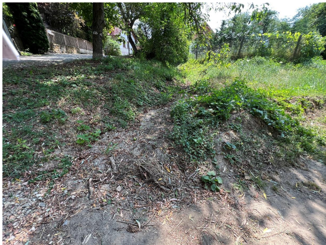
17. kép – Fő tér 824 hrsz. árokkárok
