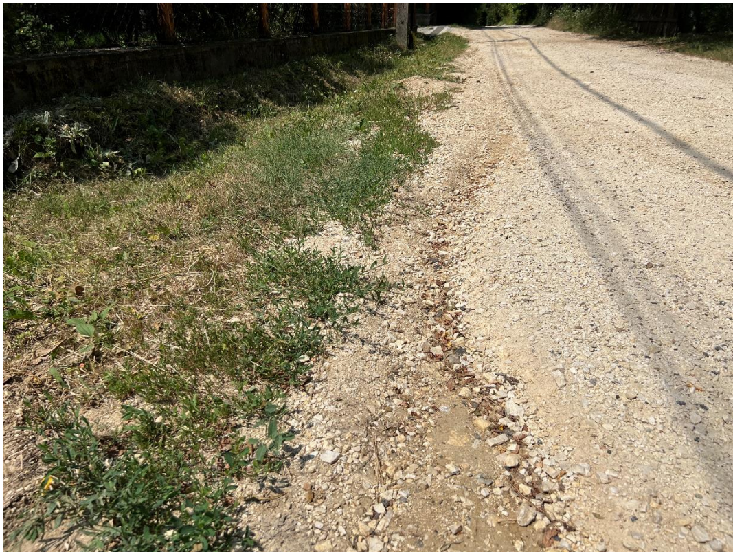
15. kép – Oszoly u. 794/41 hrsz árokkárok
